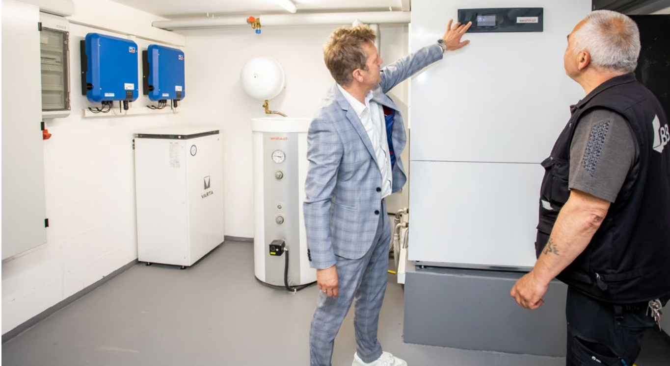
Im Neubau ist neben der Photovoltaikanlage mit Batteriespeicher auch eine Wärmepumpe im Einsatz.
