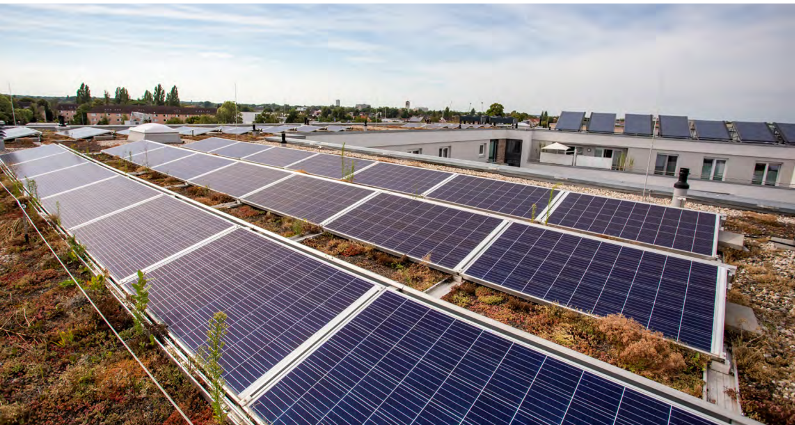
Photovoltaikanlage im Lampadiusring
